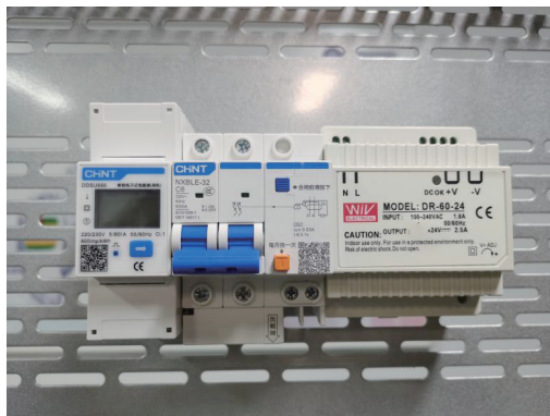
图3-1 断路器、电能表、开关电源的安装效果
