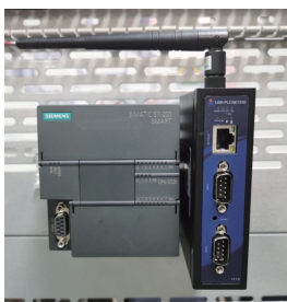
图3-2 PLC和PLC云网关安装效果
